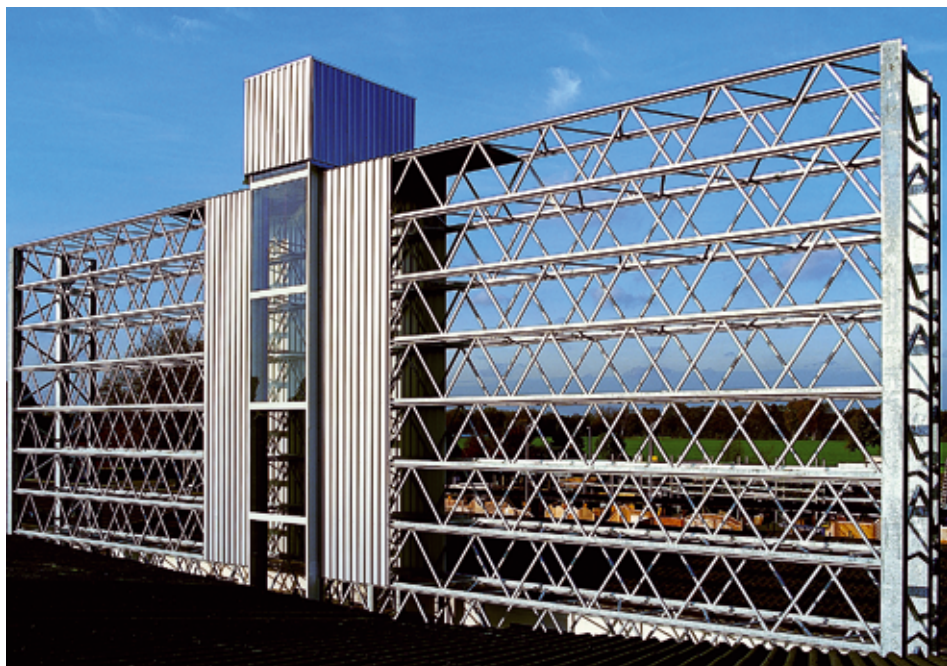
Die Pilotanlage kurz vor der Inbetriebnahme bei einem Baustoffgroßhandel
